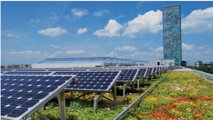
Abb. 4: Kombination von durchdringungsfrei montierter PV-Anlage, Absturzsicherung und Dachbegrünung auf dem Münchner Technologiezentrum (Foto: ZinCo GmbH)
