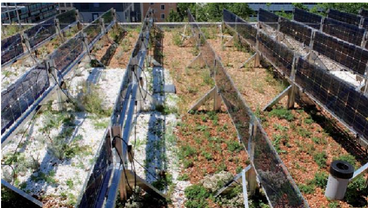
Abb. 5: Bifaziale Module in 90°-Aufstellung bei einem Forschungsprojekt zur Weiterentwicklung von PV-Gründächern in Winterthur (Foto/Betreiber: Verein SolarSpar/Modulhersteller: Megasol Energie)
