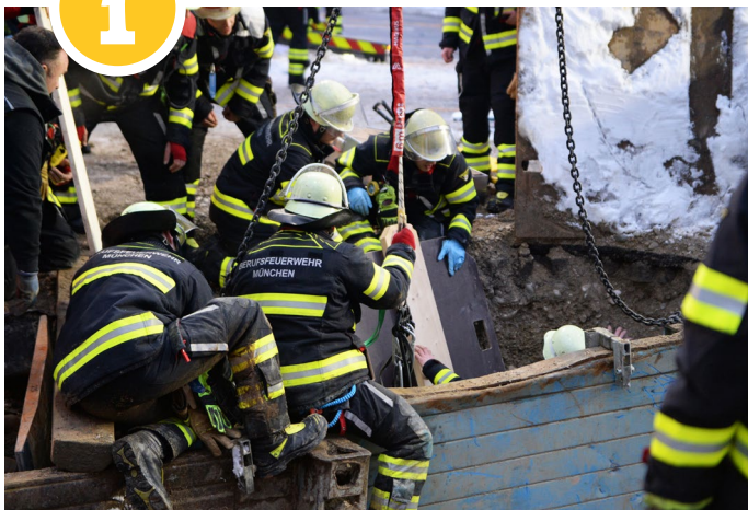
DEZEMBER | Bauarbeiter verschüttet
