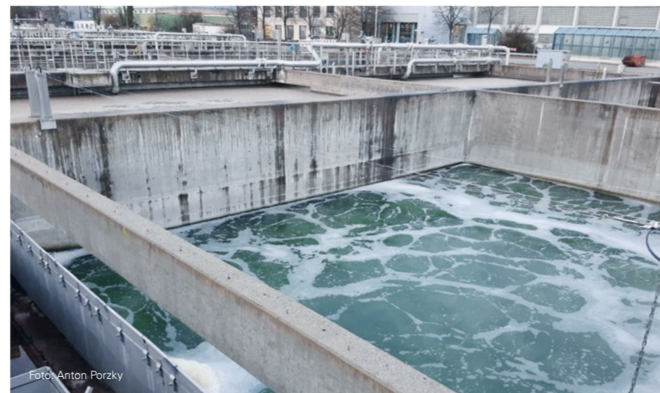
Biologische Reinigungsstufe Klärwerk Gut Großlappen
