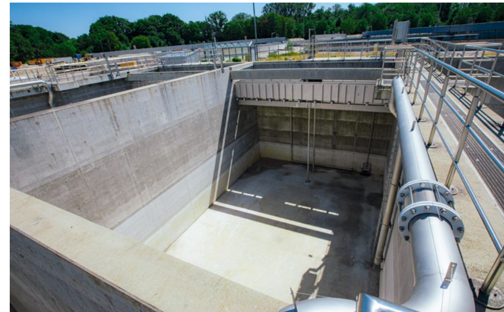
Ein noch leeres Belebungsbecken der neuen Biologischen Reinigungsstufe im Klärwerk Gut Großlappen
