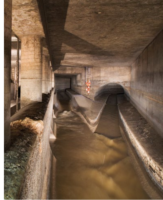
Der Abwasserzufluss zu den beiden Klärwerken wird durch unterschiedliche Schieberstellungen in den Verteilerbauwerken zentral von den Warten der Münchner Klärwerke aus gesteuert. Um die Funktionsfähigkeit zu sichern, müssen sie regelmäßig kontrolliert werden.
