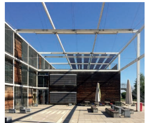
Abb. 2: Teilweise Überdachung von Flachdachbereichen – Grundschule mit Tagesheim am Hildegard-von-Bingen-Anger, München (Schürmann Dettinger Architekten, Foto: Roland Krippner).
