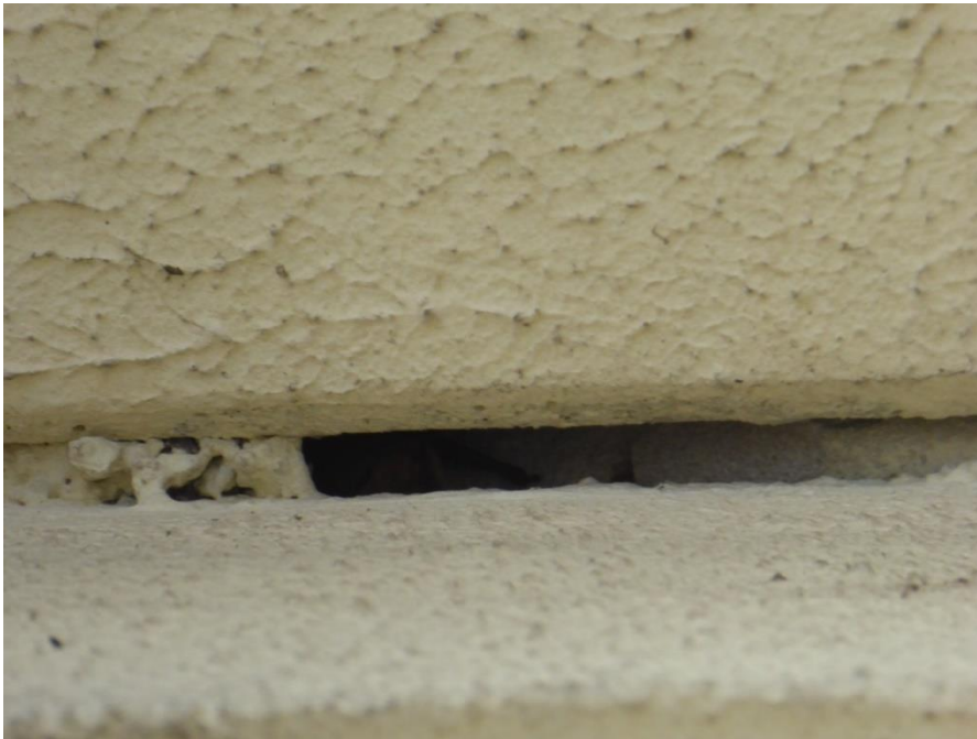
Abbildung 14: Spaltenquartier an Gebäude 2 (vgl. Abb.4).
