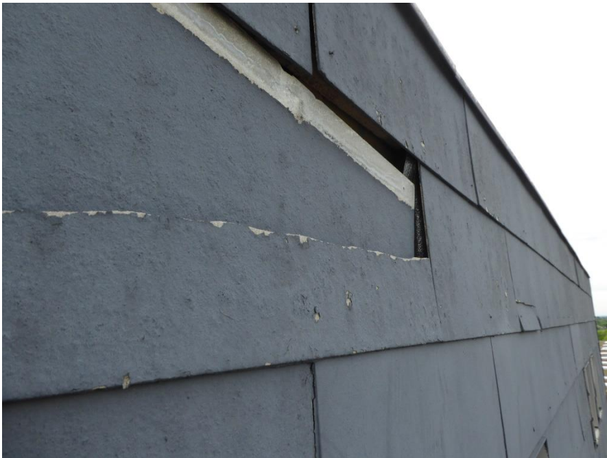
Abbildung 9 - 10: Ebenfalls an fast allen Gebäuden befinden sich umlaufende Attikableche, hinter denen sich Fledermäuse bestimmter Arten aufhalten können. Bauschäden sorgen für Zugänge hinter die Fassaden.
