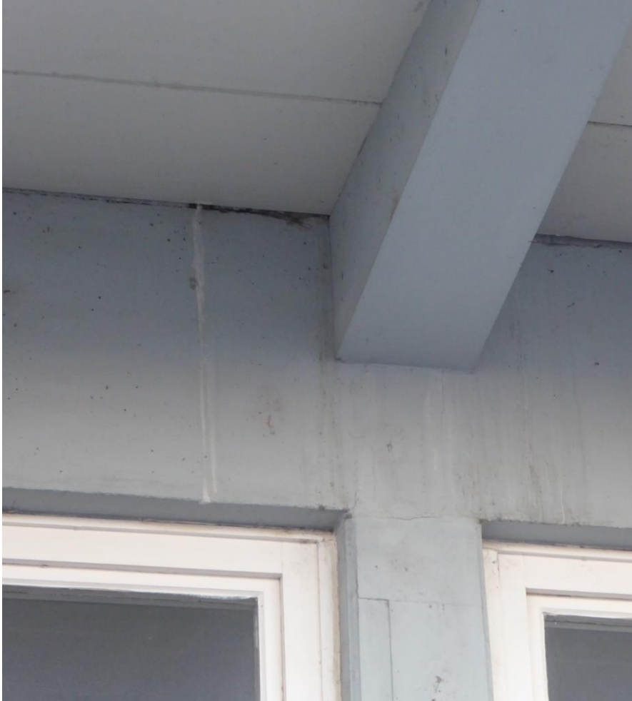
Abbildung 11: Quartiereingang in Spalte unter dem Dachüberstand an der nördlichen Fassade vom Gebäude 1.
