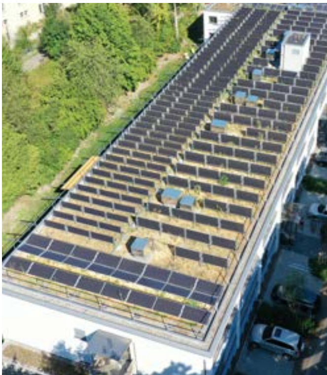
Abbildung 7: PV-Anlagen mit senkrecht/bifazialen PV-Modulen sowie in einem kleinen Bereich PV-Module in Schmetterlingsform aufgeständert. (Quelle: Zinco)
