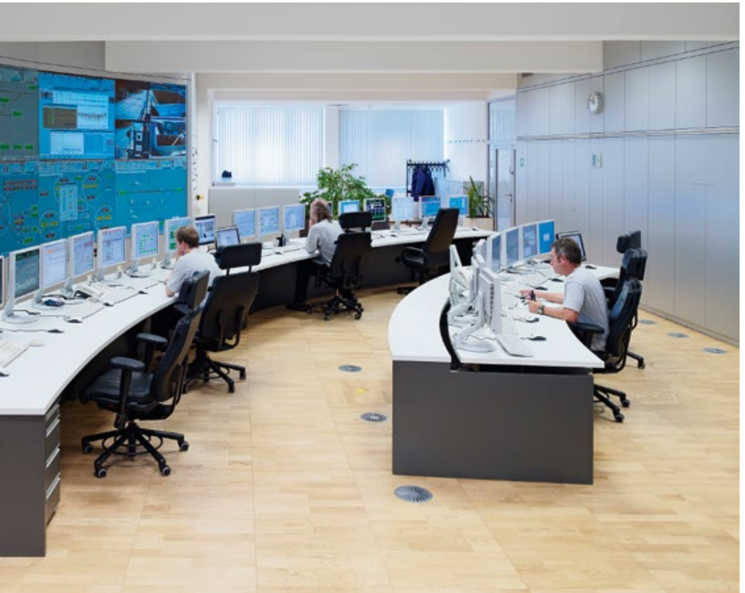
Die Leitwarte der Klärwerks Gut Großlappen. Von hier aus werden der Betrieb des Klärwerks und das Kanalnetz gesteuert und geregelt.
