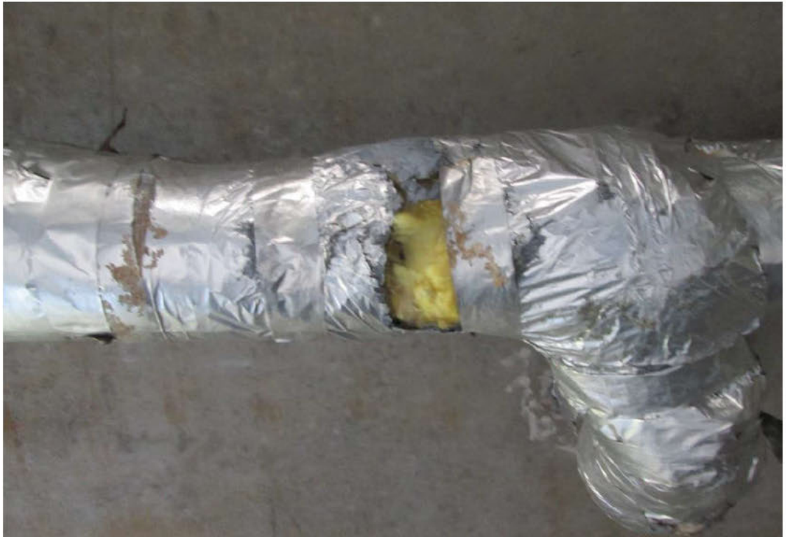
Foto 7: Gebäude K11, Rohrisolierung KMF
