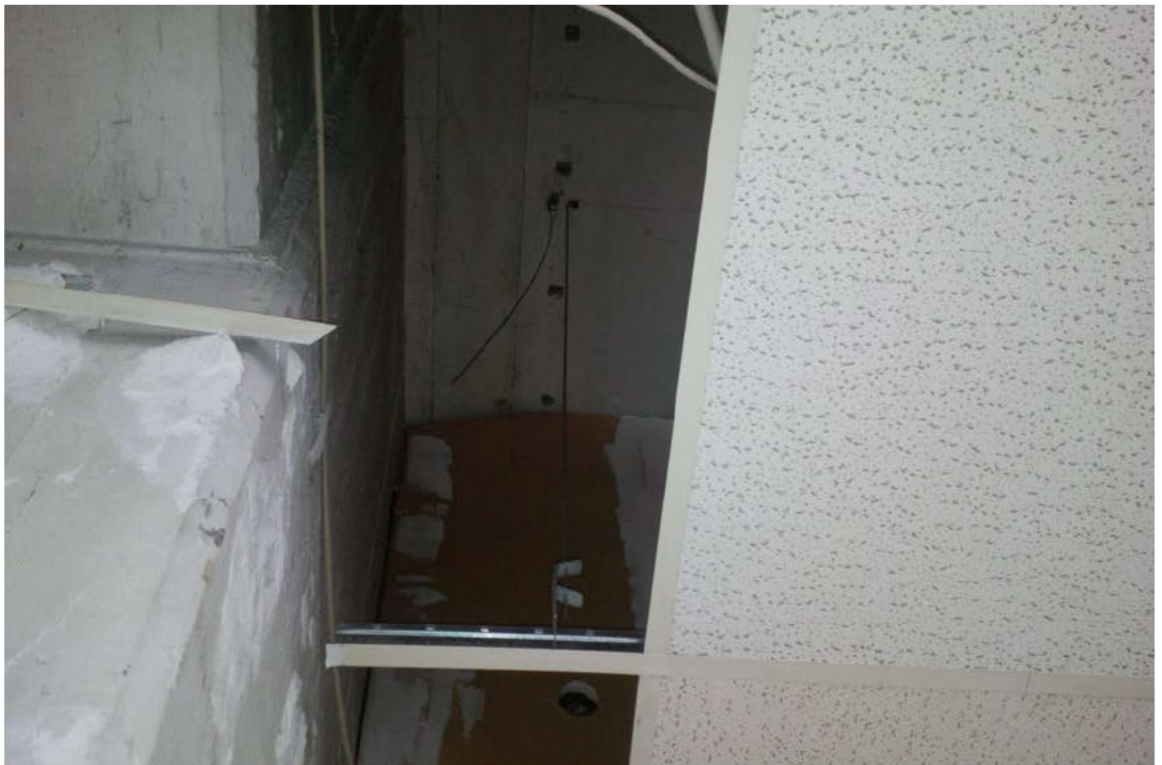
Foto 17: Gebäude RhlI, 2. OG, abgehängte Decke
