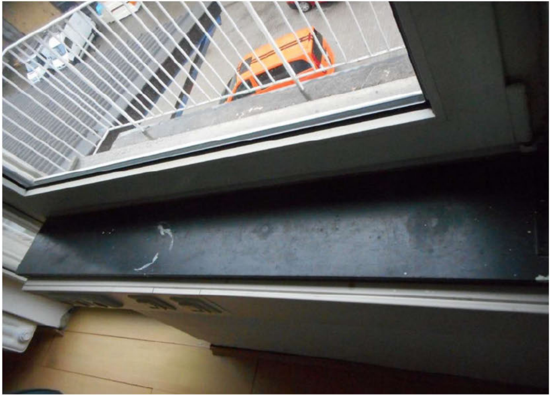
Foto 13: Gebäude Rhl, Verwaltungstrakt, II. OG, AZ-Fensterbrett
