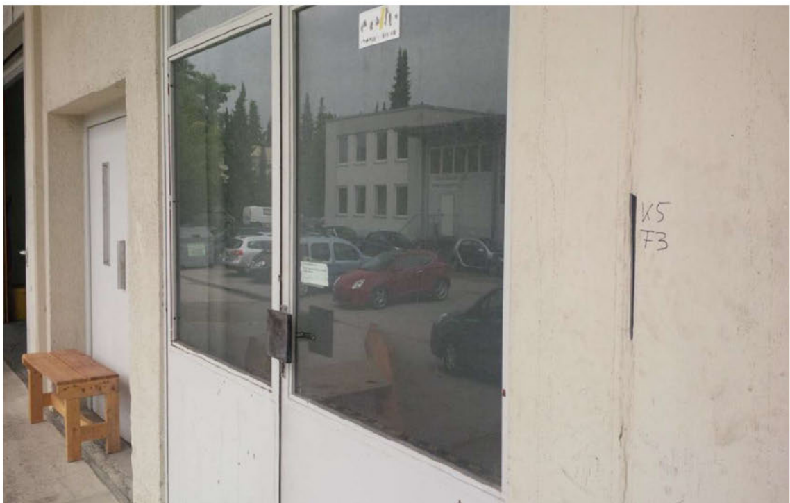
Foto 12: Gebäude K5, Außenfassade mit Fuge
