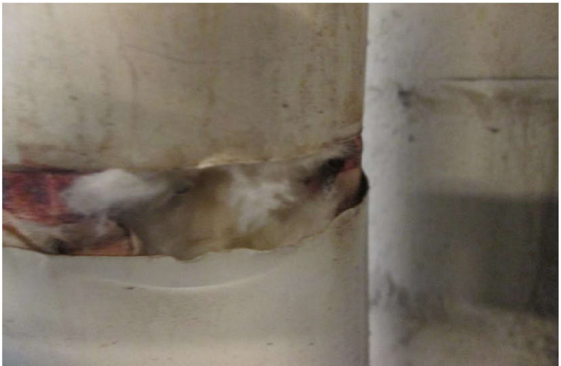
Foto 8: Gebäude K11, Rohrisolierung KMF
