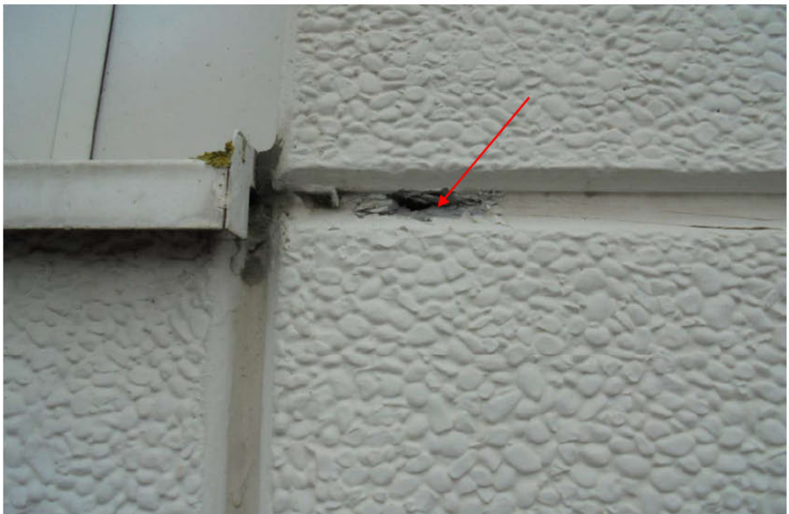
Foto 2: Gebäude K9, Fassadenplatte mit Fuge
