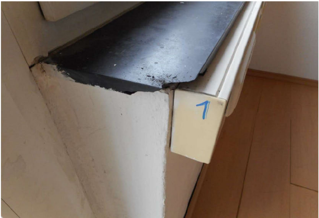
Foto 14: Gebäude Rhl, Verwaltungstrakt, II. OG, AZ-Fensterbrett
