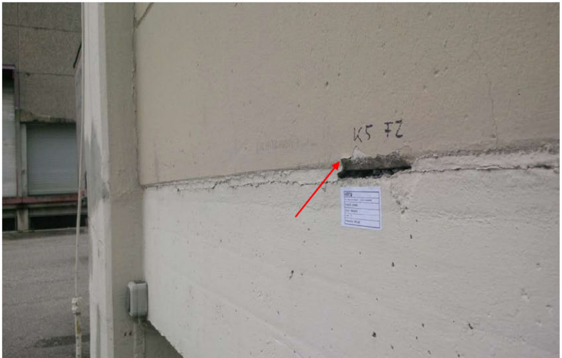
Foto 11: Gebäude K 5, Gasbetondiele mit Fuge
