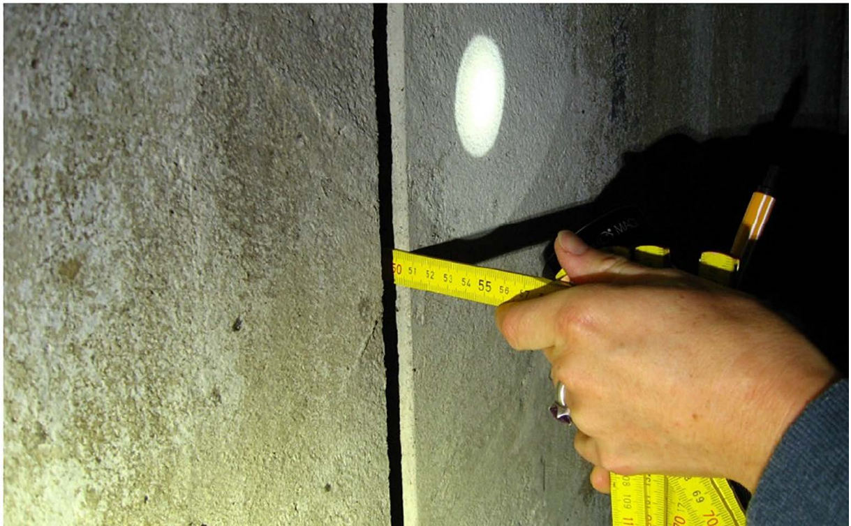
Abbildung 4: Tiefe der Spaltenquartiere bis zu 50 cm. (Quelle: Gerges 2019)
