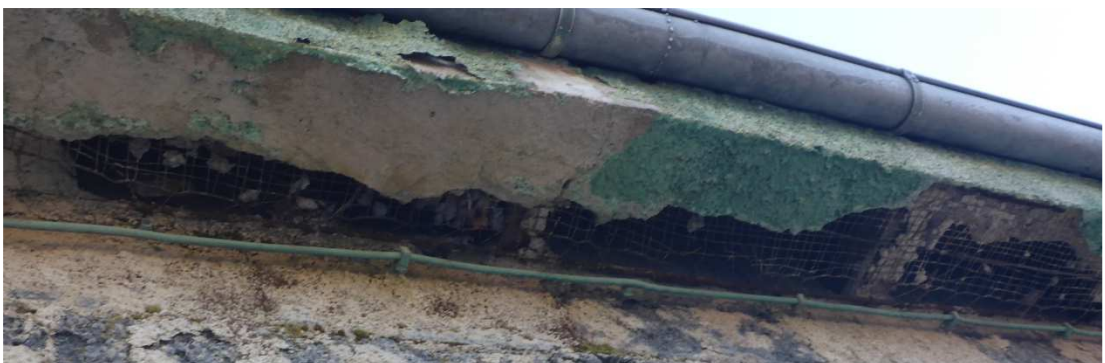
Abb. 14 Verwitterung des Gebäudes führte zu zahlreichen Öffnungen und Spalten
