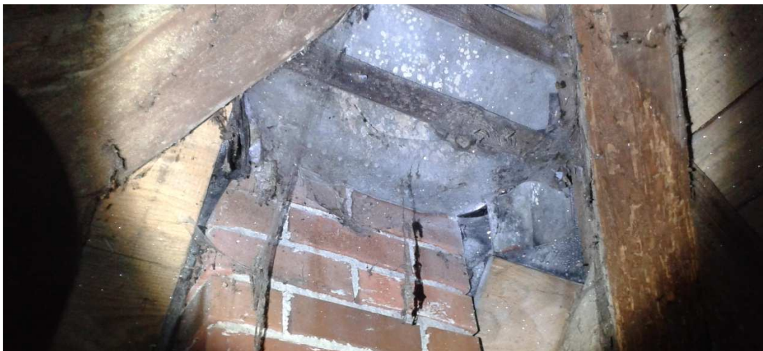
Abb. 18 Spalten am Schornstein
