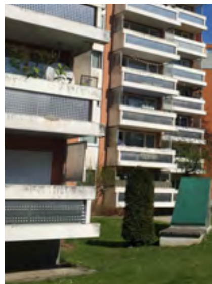
29. In Gebäuden in schlechtem Sanierungszustand steigt der Energieverbrauch und das Risiko von Energiearmut.
