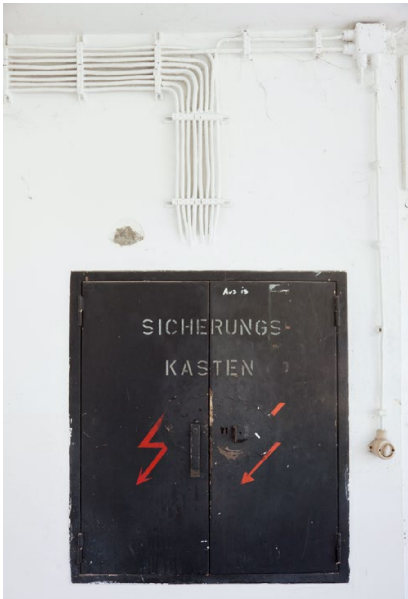
Auch für Zwischennutzungen werden Strom, Wasser und ein Abwasseranschluss benötigt.
