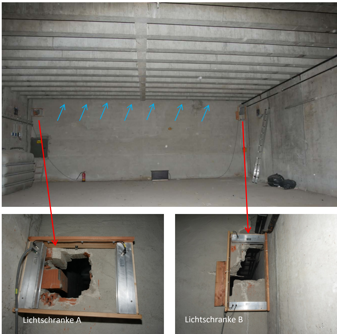
Abb. 4: Blick auf die Wand zum Heizungskeller. An den beiden deckennahen Öffnungen auf der linken bzw. rechten Seite wurde jeweils eine Fledermauslichtschranke installiert. Die durchgehende Spaltenöffnung an der Decke wurde dabei jedoch ausgelassen (blaue Pfeile). (Quelle: Kugelschafter 2020)
