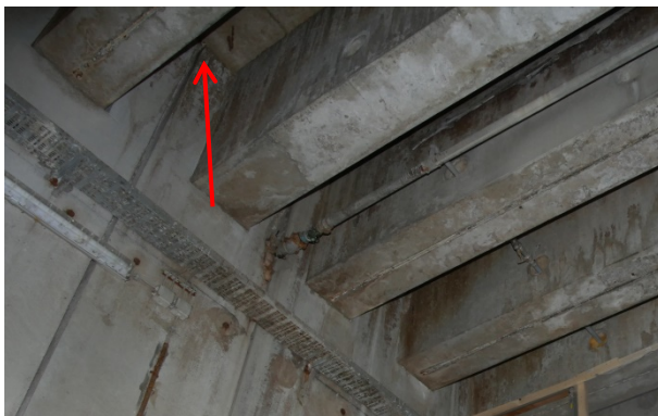
Abb. 13: Zwischen den Querträgern gibt es eine Vielzahl kleinster Spalten, die von den Zwergfledermäusen genutzt werden können, und wie die Befunde von [REDACTED] belegen, auch tatsächlich genutzt werden. (Quelle: Kugelschafter 2020)
