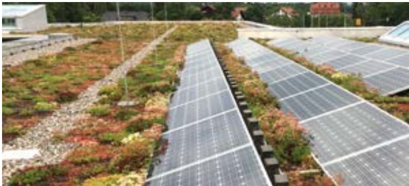
Extensive Dachbegrünung und Photovoltaik.
