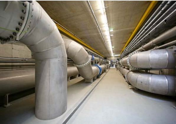
Die modernisierte 1. Biologische Stufe im Klärwerk Gut Großlappen
