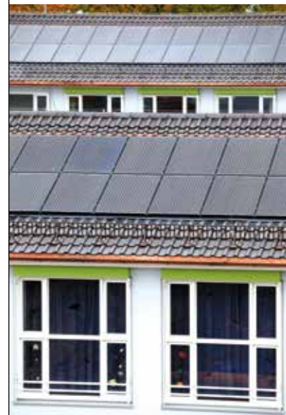
Photovoltaikanlage auf dem Dach der Grundschule an der Paulckestraße
