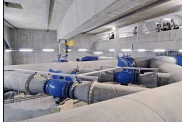
Im SWM-Betriebshof Deisenhofen schließt die neue Trinkwasserleitung aus dem Mangfalltal an das bestehende Netz der Münchner Trinkwasserversorgung an.
