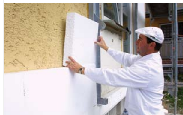
Die Wärmedämmung von Gebäuden wird von der Stadt gefördert.
