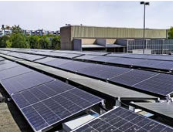
Die Photovoltaikanlage Perlach, ein Baustein für mehr Sonnenstrom.
