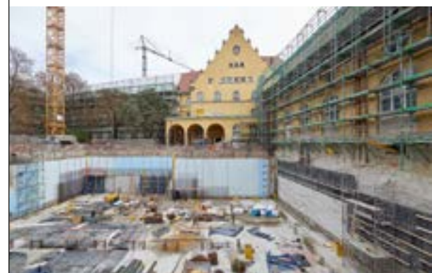
Im Rahmen des Schulbauprogramms wird auch das Oskar-von-Miller- und Maximiliansgymnasium saniert und erweitert.
