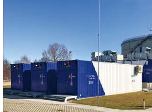
Ein Batterie-Großspeicher am Heizkraftwerk Freimann soll künftig einen stabilen Stromnetzbetrieb sicherstellen.
