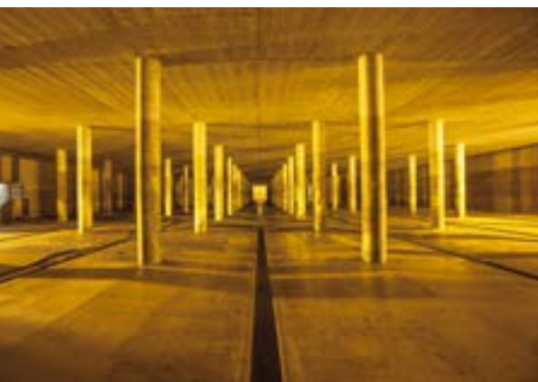
Regenrückhaltebecken der Münchner Stadtentwässerung am Hirschgarten
