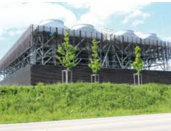
Geothermie-Anlage der SWM in Sauerlach
