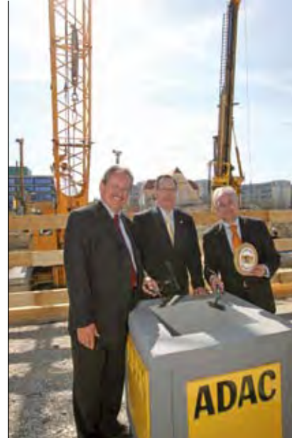
OB Ude, ADAC-Präsident Peter Meyer und Staatsminister Erwin Huber legen den Grundstein für die neue ADAC-Zentrale.
