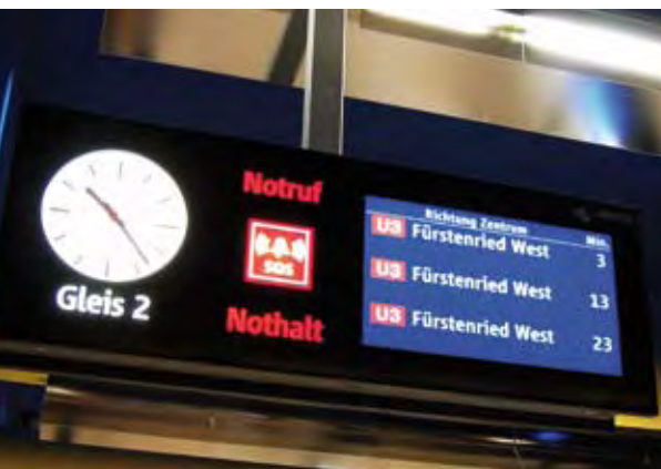
In den U-Bahnhöfen werden neue dynamische Zugzielanzeiger installiert.
