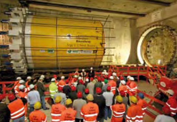
Tunneltaufe mit Tunnelanstich für die bergmännische Verlängerung der U 3 Nord nach Moosach
